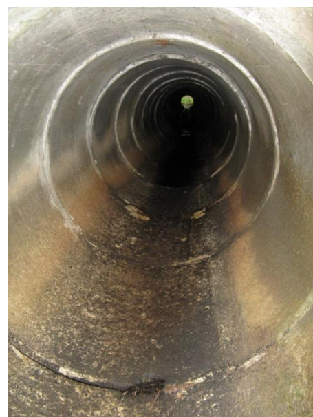
Figur 9. Nedströmssidan om den östra trumman, inget vatten rinner ut genom trumman.
