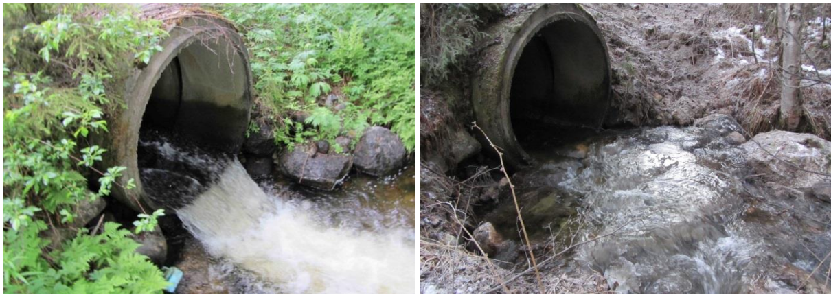
Figur 3. Nedre delen av vägtrumman under Tallbergsvägen före respektive efter trösklingen.
