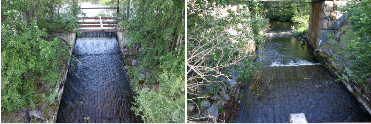
Bild 3a och b. Sarvträskdammen med skibord, fotoriktning uppströms respektive nedströms dammen. Stenfundamenten som syns i bild b är järnvägsbron.
